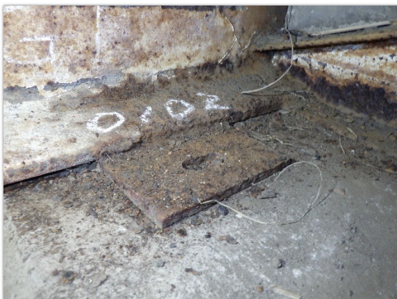
写真5. 支承の機能障害
