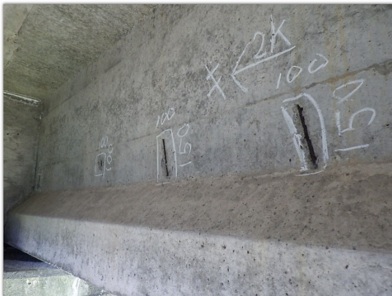
写真3. コンクリート桁の剥離・鉄筋露出
