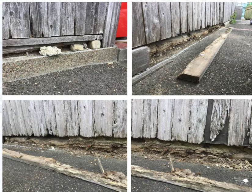
○土台の腐食、浮き
